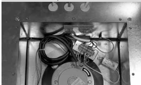
Obrázek 9 – vnitřní uspořádání elektroinstalace RPH
